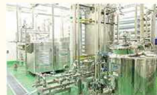
生乳を殺菌・加工する設備
