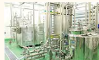
生乳を殺菌・加工する設備
